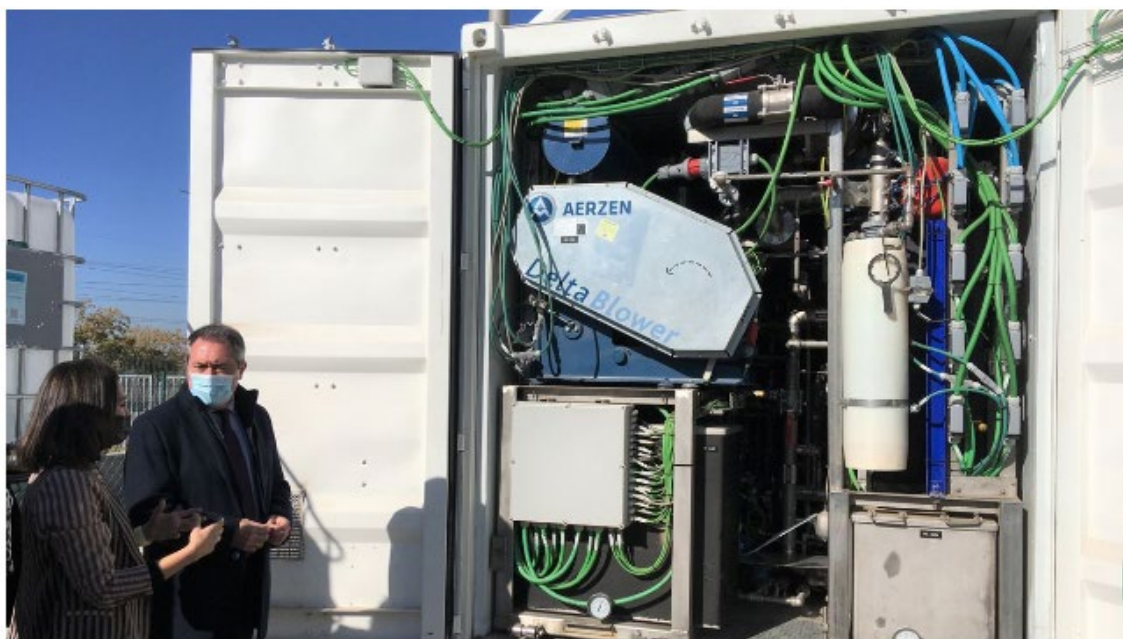
Las puertas abiertas del contenedor permiten ver las tripas de la planta de hidrógeno.
